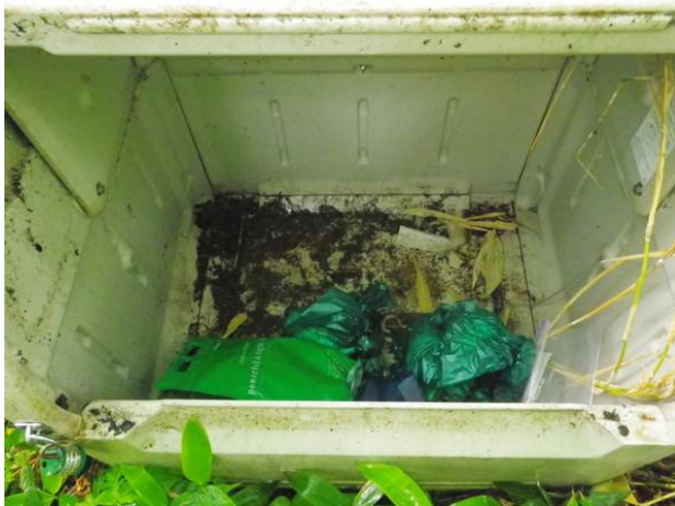
（写真 28） ボックスの中にゴミは入っていないか ったが、筐が進出していた
