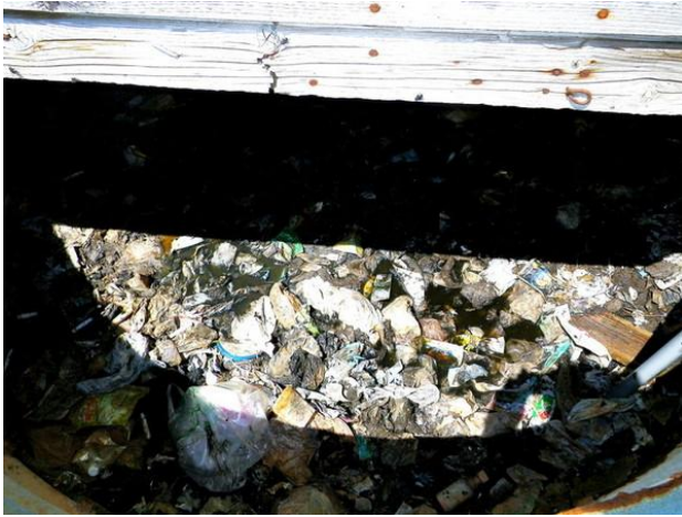
(写真3) 便槽の裏側。今春にゴミ袋が入れられたらしい。最悪のケースだそうだ
