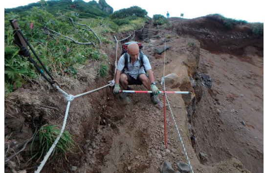
図4. 合流点直下の路肩崩落地点。
