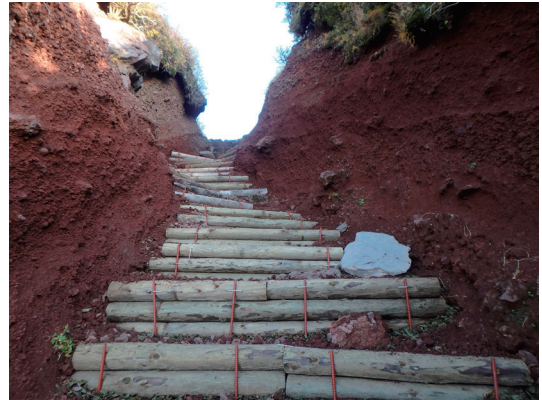
図3. 通称3mスリットに設置された土留工。
