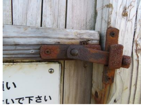
ドア外側の錆びた開閉鍵（2020 年）
