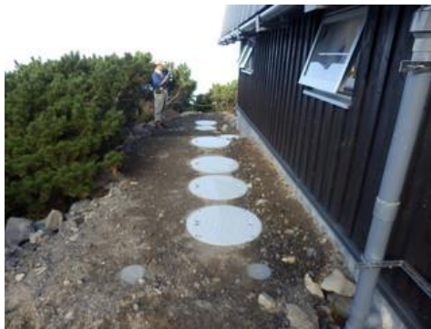
羊蹄山土壌処理・マンホール群
