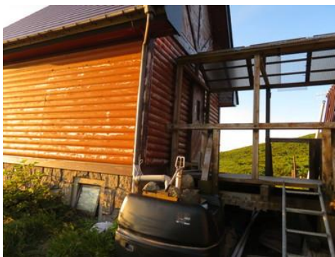
トイレの裏にある雨水を利用した 清掃用のポンプ付き水タンク
