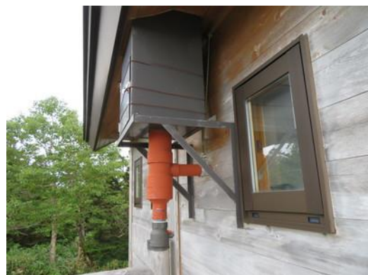
雨水を貯めて小屋内のタンクに貯留
