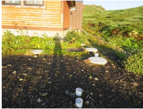
土壌処理装置のマンホール群
