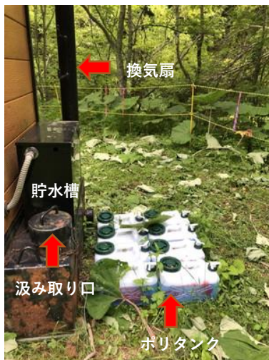
トイレ裏に水洗用ポリタンクがある。 洗浄液が出なくなったら、タンクの 水を貯水槽に入れる
