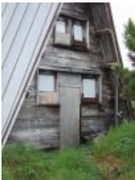
右側面全体の傷みが酷い
