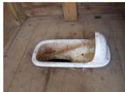
右トイレのひび割れた便器
