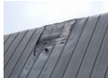
トタン屋根の剥がれた部分
