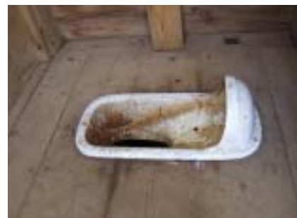
右トイレのひび割れた便器
