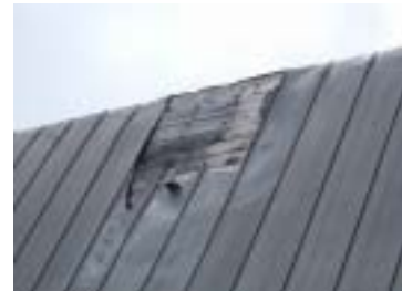
トタン屋根の剥がれた部分
